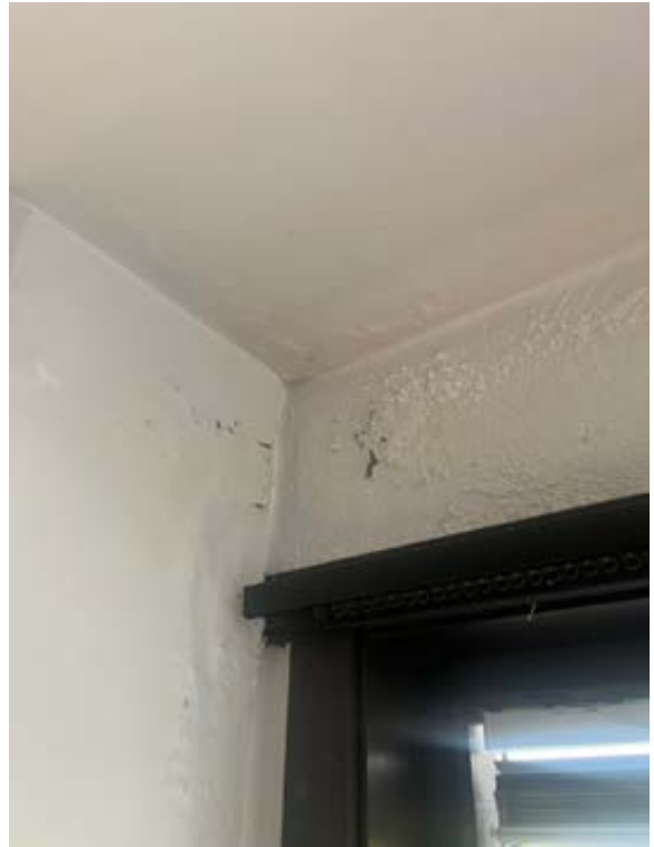
Maling som flasser og stedvis saltutslag
