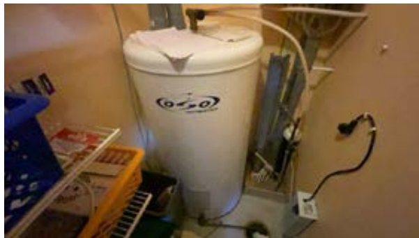
Varmtvannsbereder plassert i bod.
