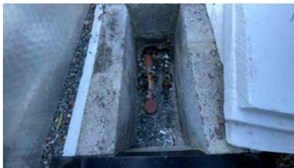
Utvendig stakepunkt og stoppekrane for vann (stengt ved dagens befarings).
