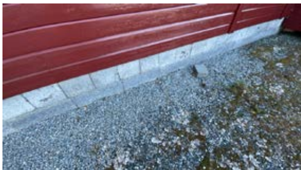
Manglende beskyttelse av lettklinkermur.
