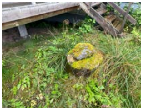
Septiktank ved tilbygg sør.
