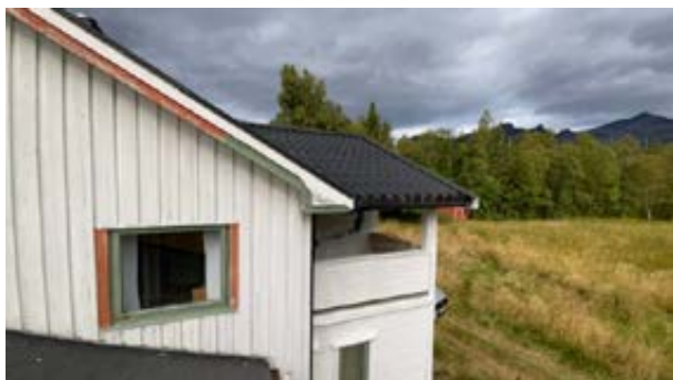
Rustskade i nedre del av taket over tilbygg.
