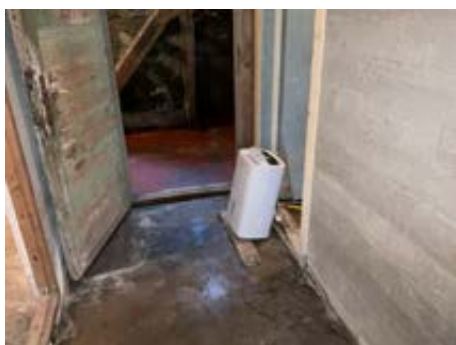
Avfukter plassert i gang, kjeller
