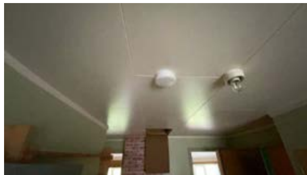
Eldre røykvarslere i tak.
