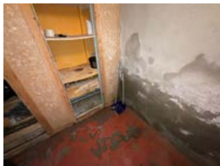
Synlig fukt på vegg og råteskadet skap ved trapp.
