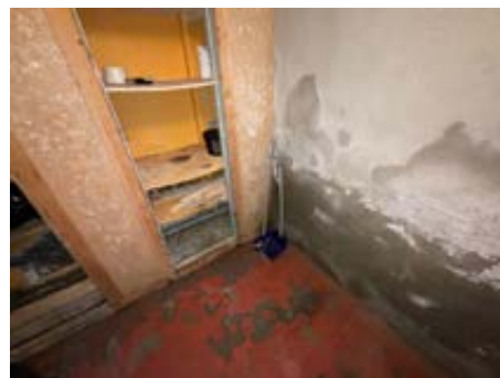
Tydelige spor av fukt på vegg og gulv. Trematerialer råteskadet ved gulv.
