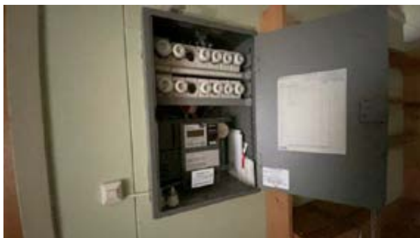
Sikringsskap med skrusikringer.
