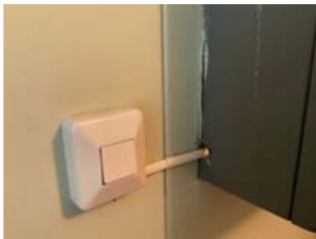
Kabelinnføring uten tetting ved bryter.
