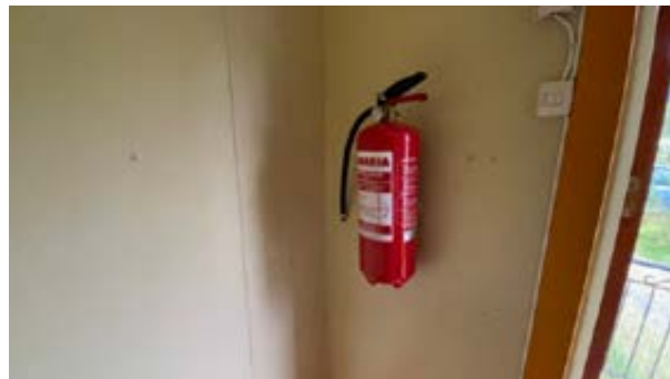
Eldre brannslukningsapparat på vegg i gang.
