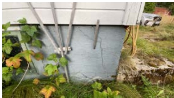
Synlig sprekk i mur, hjørne sørøst.
