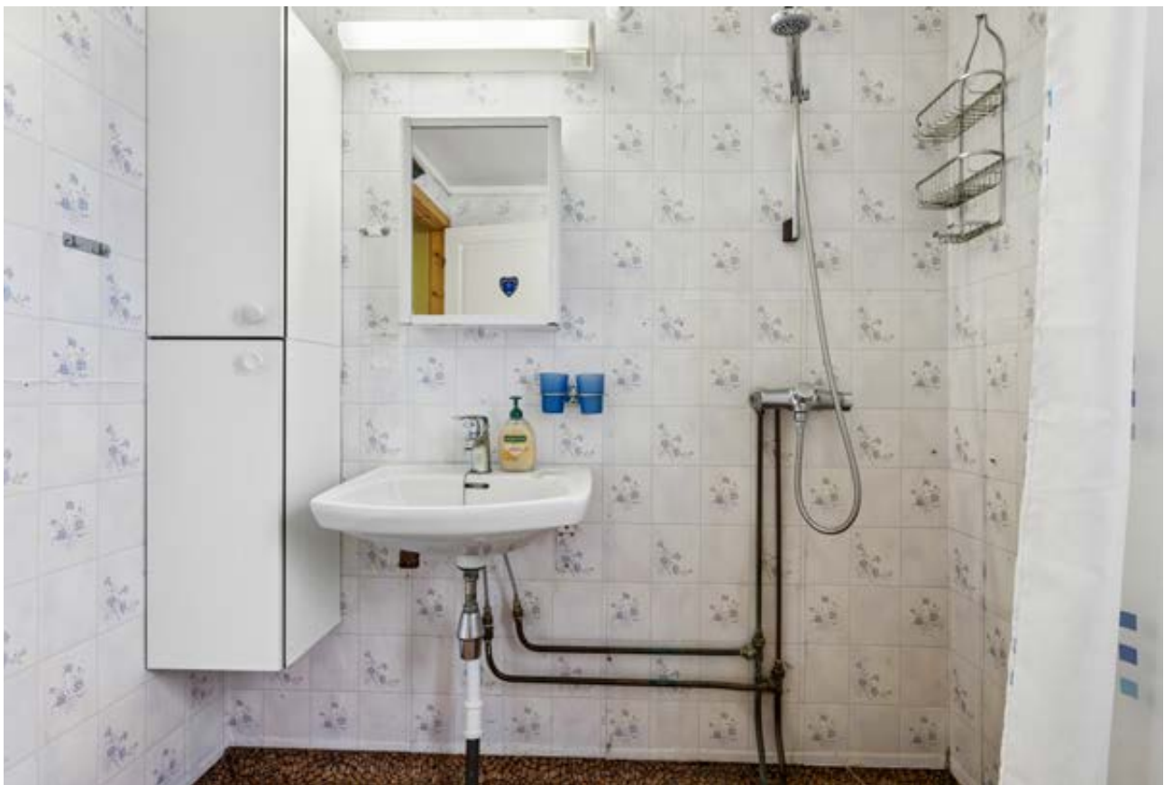
Bad med dusjslange på vegg
