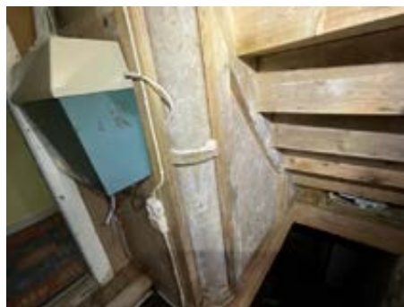
Synlig mugg på vegg i trapp.
