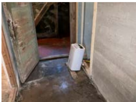
Avfukter plassert i kjeller ved befaring.
