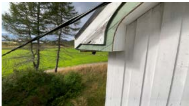
Råteskade hjørne sørøst.
