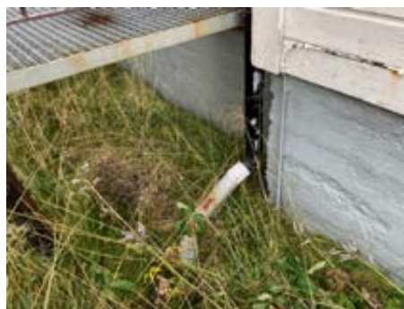
Taknedløp ført til bakken, ikke ledet vekk fra grunnmur.
