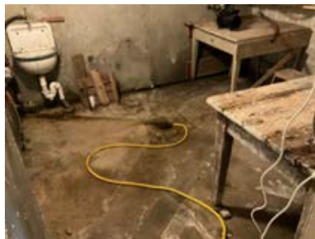
Fukt på gulv i kjeller
