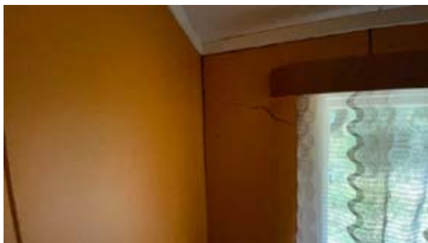
Synlig fuktskade i plater på vegg.
