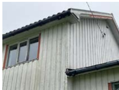
Nedløpsrør mangler mot sørvest både på hovedtak og på tilbygg.
