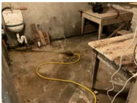
Vanninntak under utslagsvask i kjeller.
