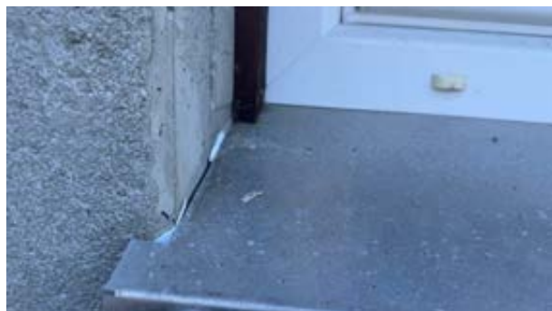
Badevindu: Utett overgang mellom vannbrett under vindu og veggkonstruksjon av betong.
