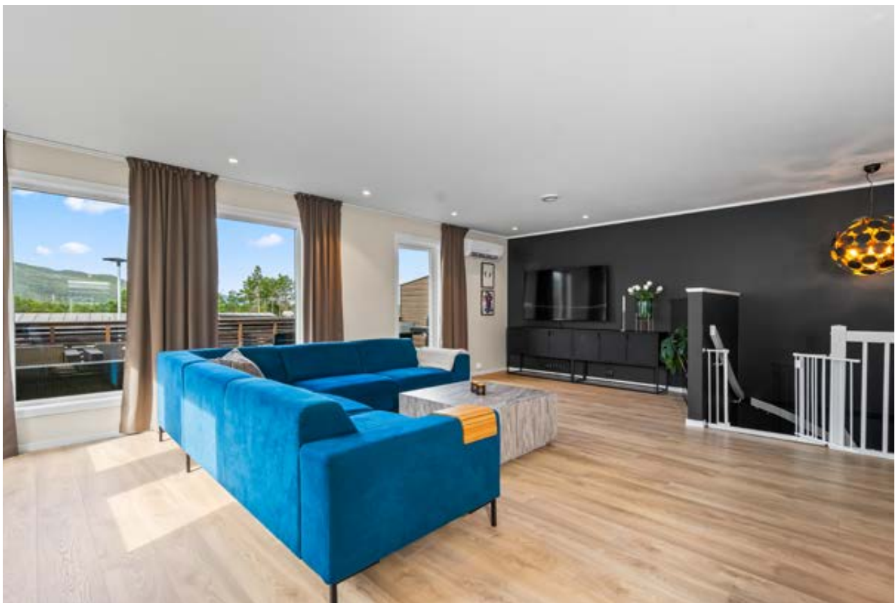
Det er montert varmepumpe i stuen
