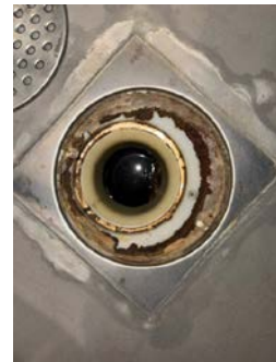
Eldre sluk. Misfarging på mikrosementen rundt slukristen.
