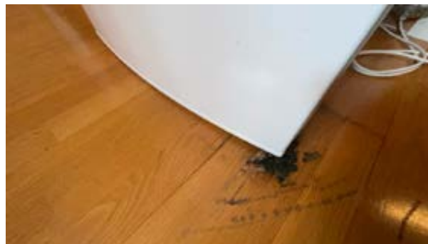
Lekkasje fra kjøleskap.
