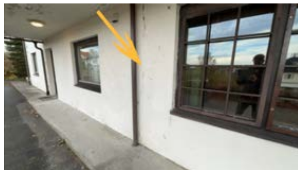
sprekk i mur.
