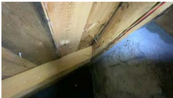
Fuktskjold rundt pipen.
