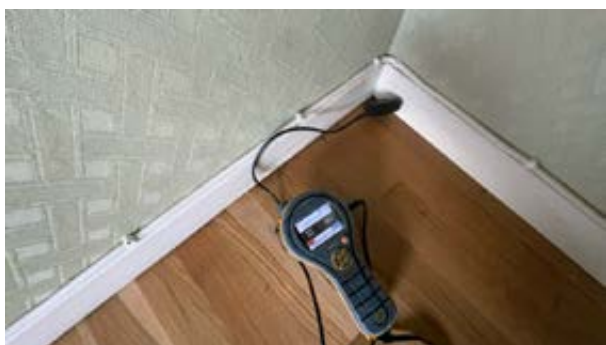
Målt fukt i listen.
