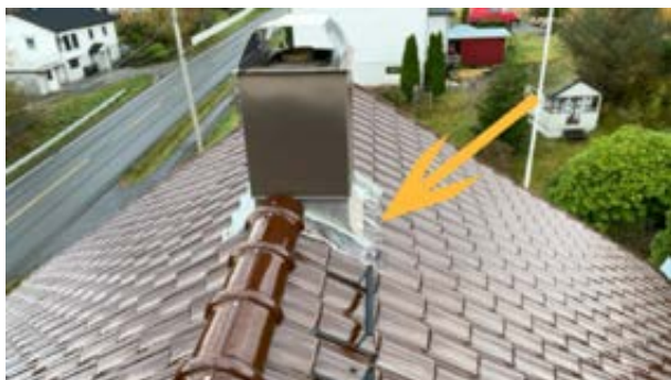
Det er observert hull i nedre del av blybeslag
