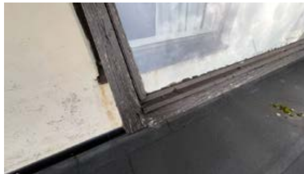
Vinduene er værslitte.
