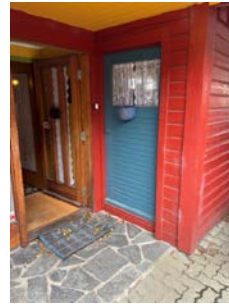
Dører har slitasje
