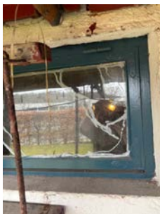
Vinduer med enkle glass er knust
