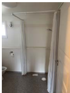
Bad med belegg på gulv og vegger
