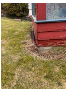
Kledning har slitasje og spredt råte
