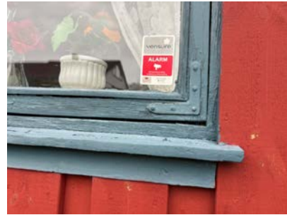
Vinduer har slitasje
