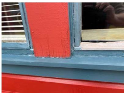
Utvendig kledning har stedvis slitasje
