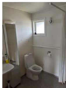
Bad med belegg på gulv og vegger
