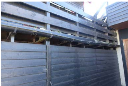
Skadet takrenne, med motfall
