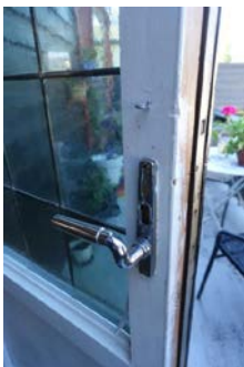
Ødelagt espagnolettlås på dobbel balkongdør
