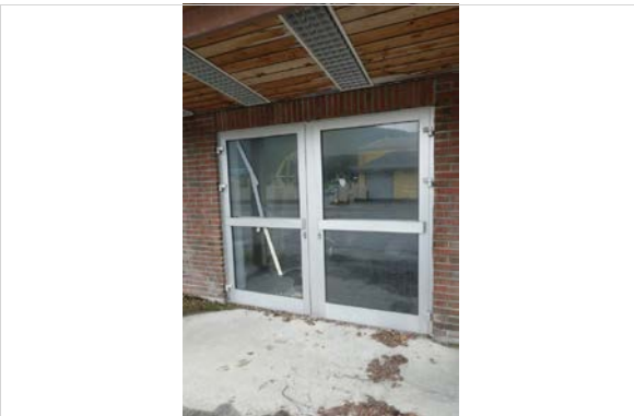
Knust glass i ytterdør
