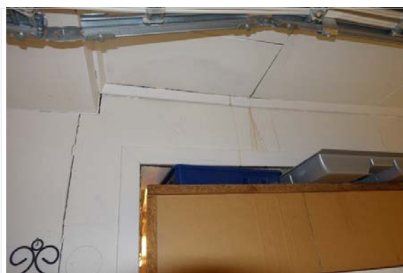
Lekkasje fra taket (tett sluk er utbedret)
