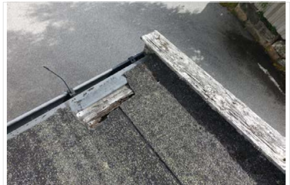
Råte v/vindski og avrevet papp
