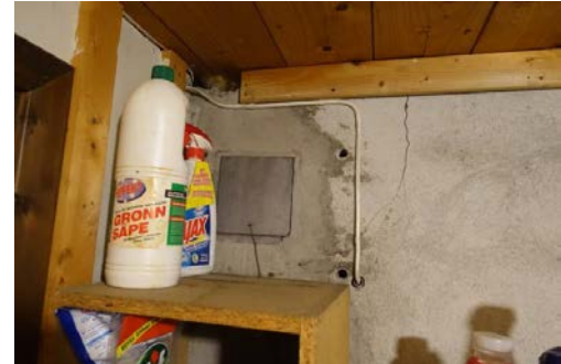
Ventil mot yttervegg på østveggen
