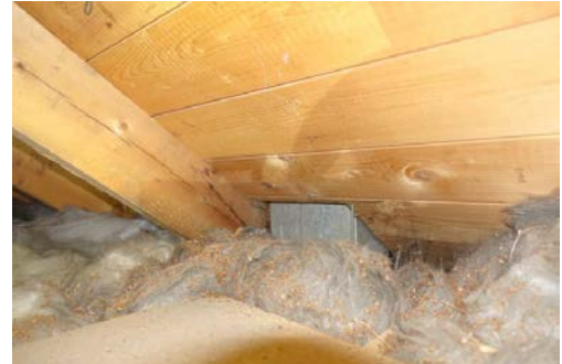
Dårlig lufting over isolasjonen ned mot raften
