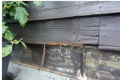
Råte ved nedre bord
