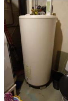
Varmtvannsbereder i vaskerom
