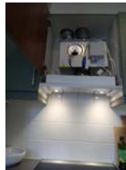
Ventilator med avtrekk fra bad.
