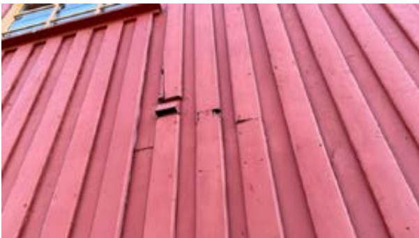
Stedvis råteskader i bordkledning.
