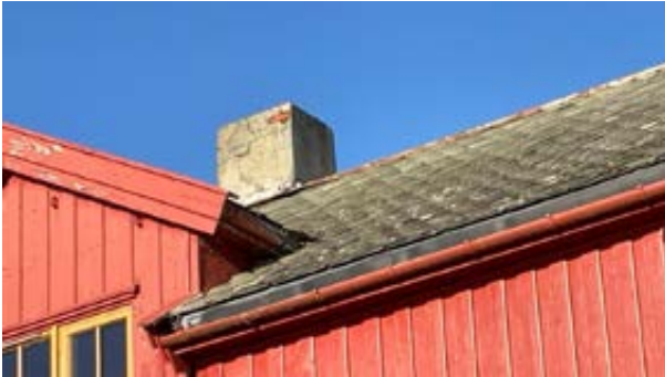
Sprekker i puss/over tak.
