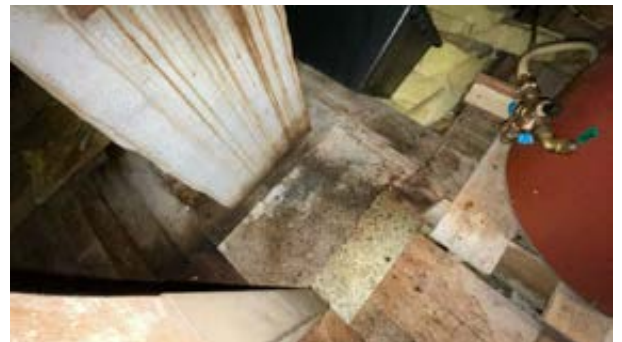
Sotvann fra feieluke på loft.
