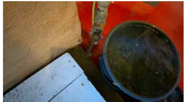
Hovedkranen er ikke funksjonell ved dagens befarings.
