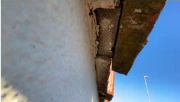
Ikke tilstrekkelig lufting i nedre del av bordkledning.
