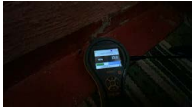
Kontrollmåling med pigg, viste 13 vekt% fukt i bunnsvill.
