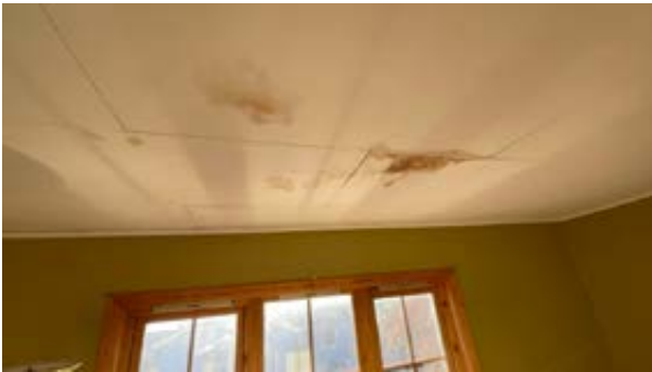
Fuktskader i tak på stue.
