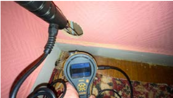
Kontrollmåling med pigg viste under 7 vekt%.
