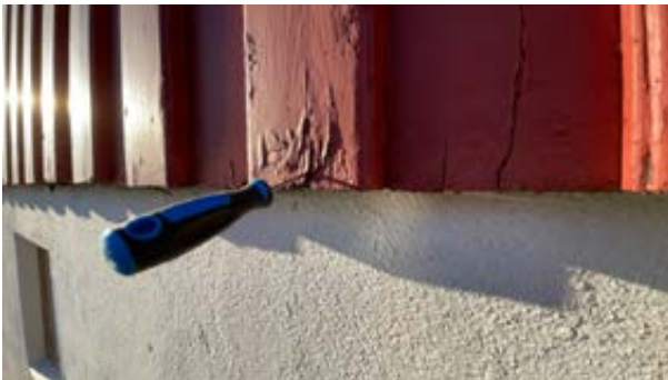
Stedvis råteskader i bordkledning.
