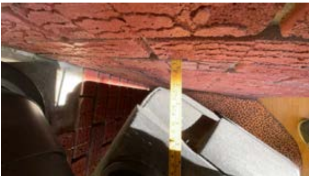
Ikke tilstrekkelig avstand mellom ildsted og brannmur.
