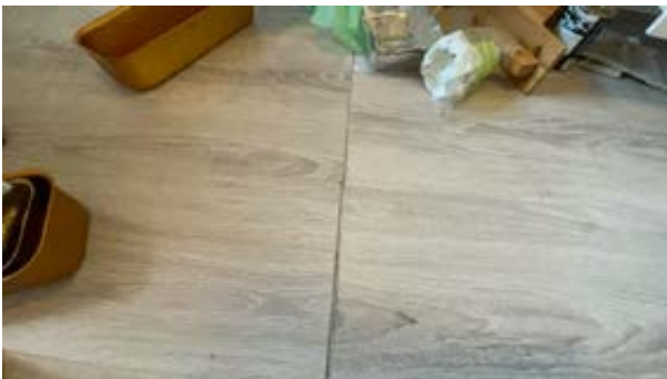
Sprekker i laminat/skjøter.
