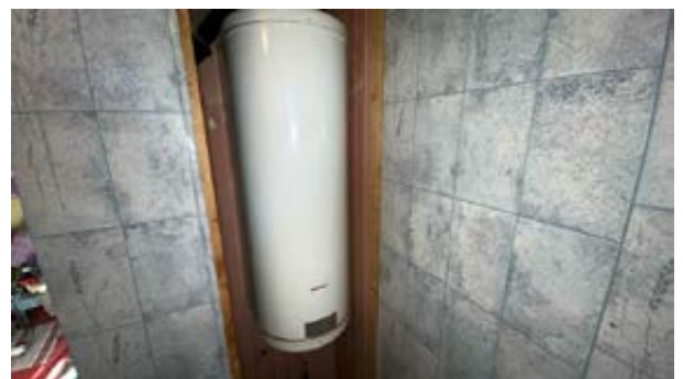
Varmtvannsbereider bad sokkeletasje.
