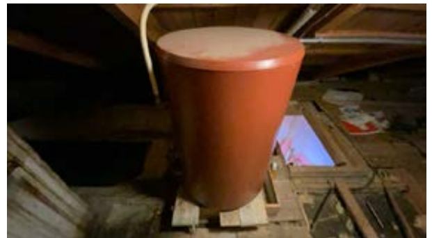
Varmtvannsbereider på loft.
