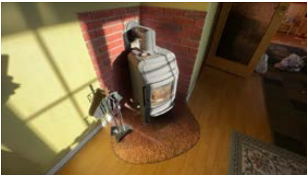
Vedovn i 1. Etasje.
