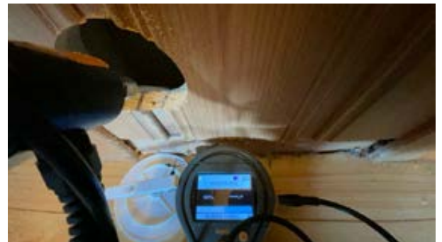
Kontroll med piggmåling ved dør viste under 7 velt% ved dagens måling.
