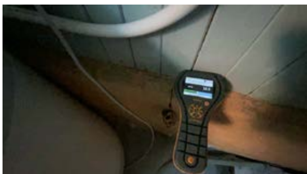
Kontrollmåling med pigg viste 16,5 vekt%, som er akkurat innenfor anbefalte verdier.
