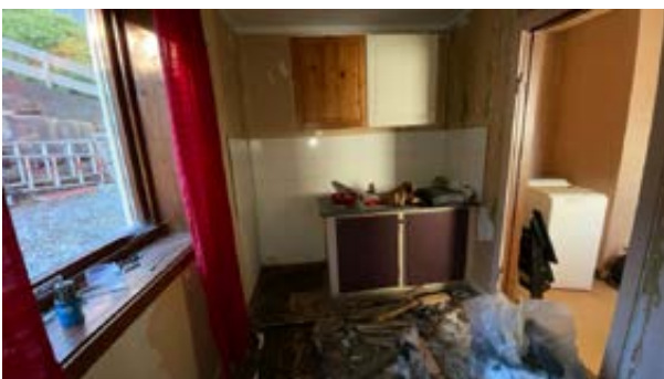
Ingen ventilering av kokesone.
