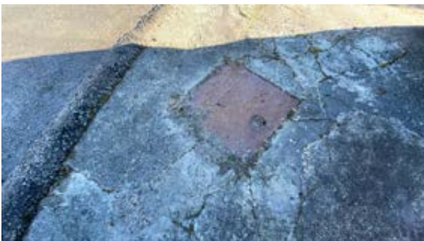
Utvendig stakepunkt, ikke besiktiget (fastfrosset)
