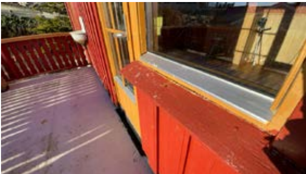
Manglende beslag på vindusbrett.
