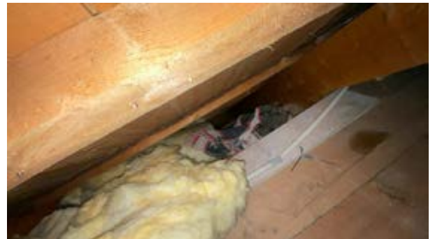
Manglende luftespalte mot varme rom.
