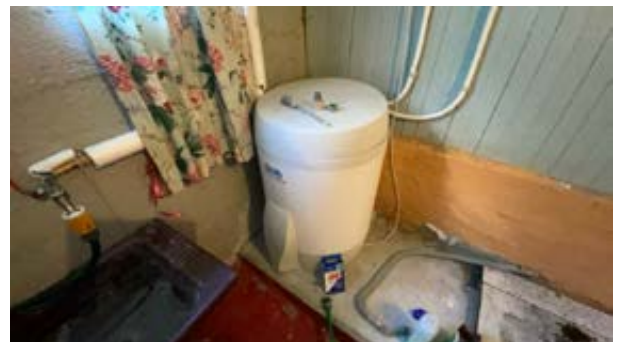
Varmtvannsbereider i vaskerom sokkeletasje.
