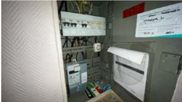
El-skap i 2. Etasje.
