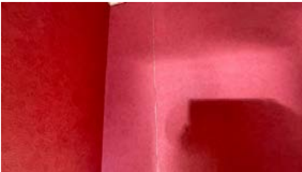
Sprekker i tapetskjøter.
