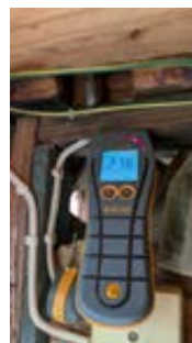
Fuktskadet tømmer sett fra innen/undersiden.
