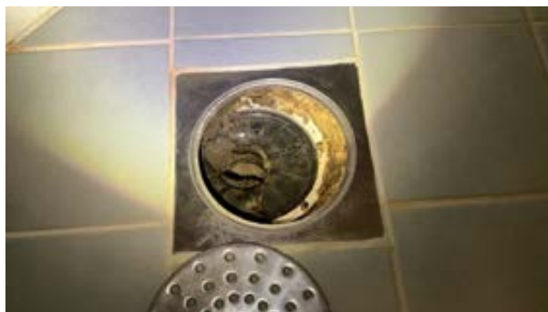
Sluk i dusjsonen
