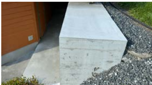
Ny mur fra 2025, manglende rekkverk.
