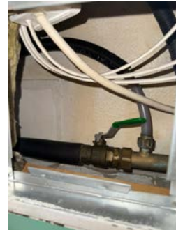
Stoppekran over himling på badet.
