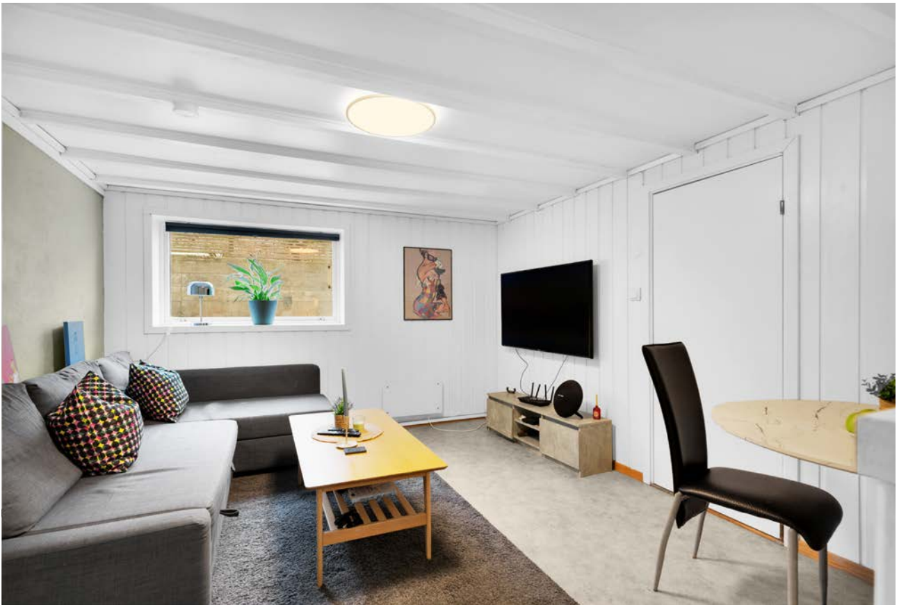
Kjellerstue. Kjelleretasjen er ikke godkjent som varig opphold. Endringene er søknadspliktige tiltak som ikke er byggemeldt eller godkjent av Stavanger kommune
