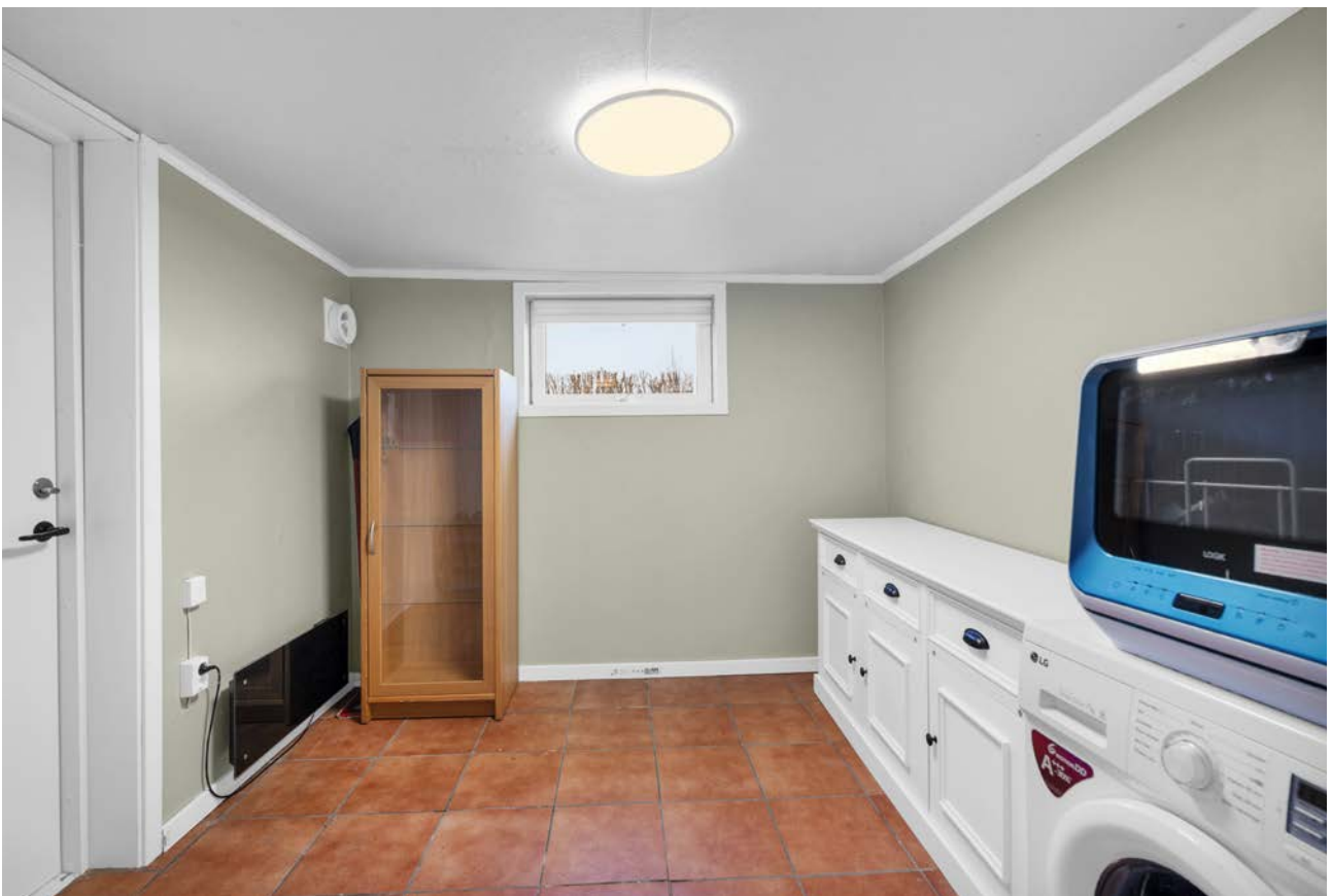
Kjeller: Gang/entrè/vaskerom. Etasjen er ikke godkjent som varig opphold. Endringene er søknadspliktige tiltak som ikke er byggemeldt eller godkjent av Stavanger kommune
