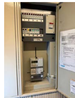
Elskap, plassert i felles trappegang.
