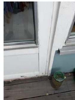
Værslitt opprinnelig terrassedør
