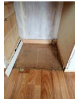
Fuktskjolder i gulv under oppvaskmaskin
