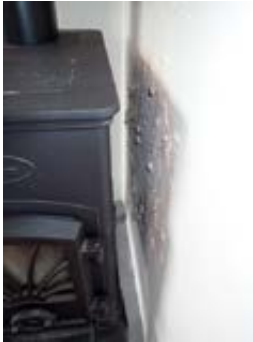
Malings avflassing på brannmur.
