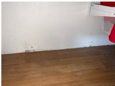
Avflasset maling ned mot gulv.
