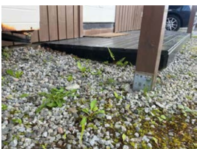
Søyle til halvtak ved inngang går til bakke.
