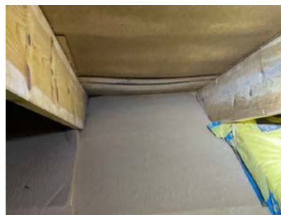
Ingen luftespalte mellom isolasjon og su-tak.
