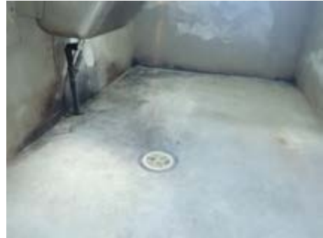
Fukt i overgang gulv/vegger på vaskerom
