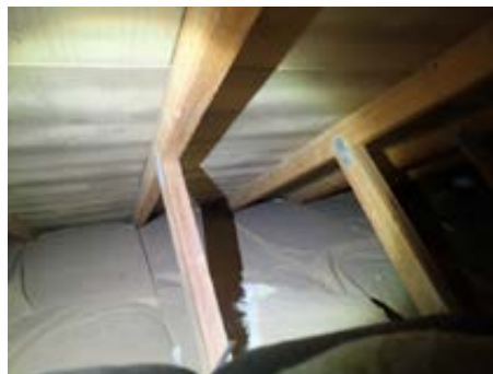
Luftespalte ved raft
