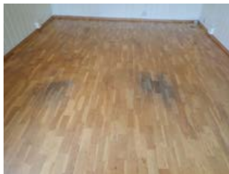
Skader i parketten på stua.
