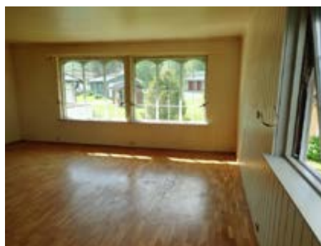
Brune vegger og tak pga. røyking
