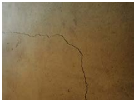
Sprekk i betonggulv
