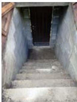
Kjellertrapp med skader i trinnene
