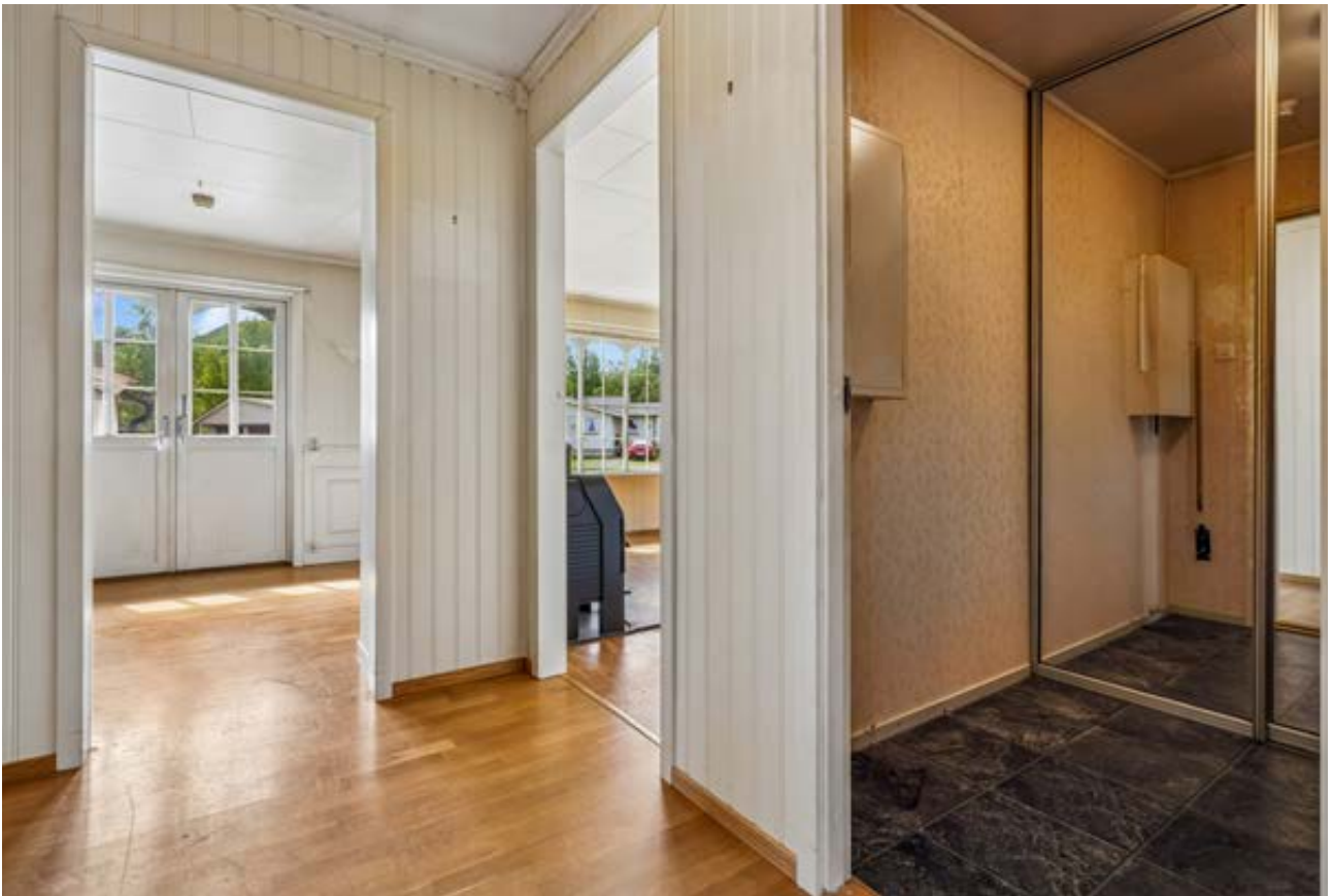
Entré m/garderoberom som har skyvedørgarderobe- sikringskap m/automatsikringer på vegg
