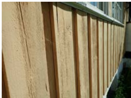
Sprekker i kledningen
