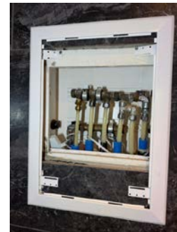
Rørskap på baderomsvegg i 2 etg
