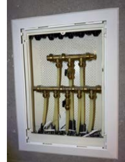
Rørskap på baderomsvegg i 1 etg
