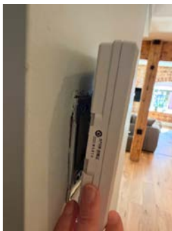
Det bemerkes løst callinganlegg ved inngang/kjøkken.
