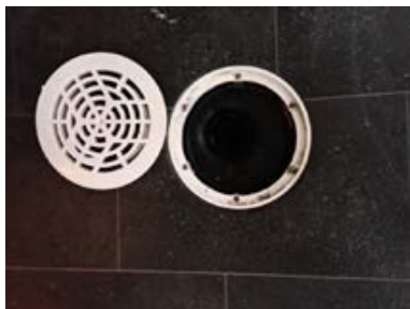
Golvbelegg klemt i sluk
