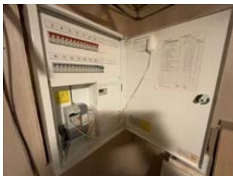
Dokumentasjon foreligger på sikringsskap
