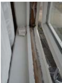
Typisk vindu fra byggeår: Vindu gang 1 etasje mot nord - eldre slitt vindu.
