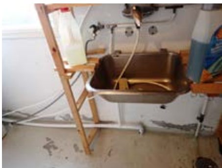
Avskalling maling mur ved golv
