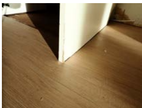
Fuktskader i skapside kjøkkeninnrending
