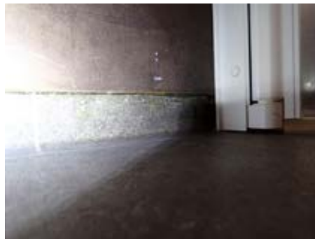
Mangler fuge overgang baderomsplater/golvbelegg
