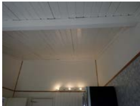
Noe oppsprekking i skjøting paneler i skråhimling soverom
