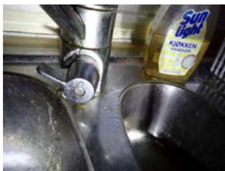
Lekasje fra benkebatteri/vannkran
