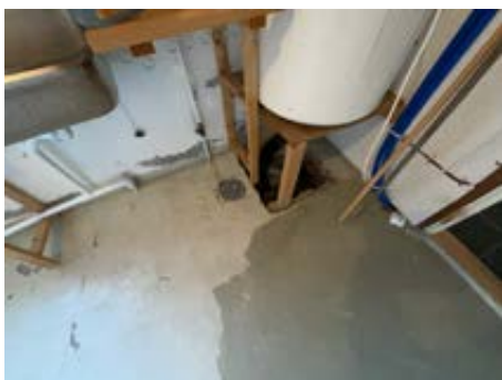
Ikke støpt igjen golv ved rørtilkobling avløp under varmtvannstank
