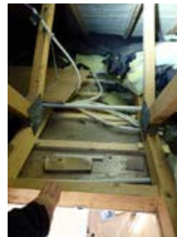
Muselort - isolasjon ikke lagt på plass
