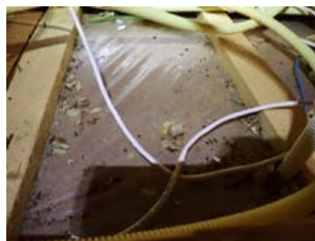
Muselort - isolasjon ikke lagt på plass
