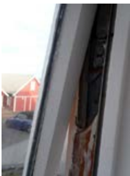
Barnesikring fungerer ikke - rustskader beslag
