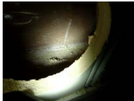
Synlig tørt i vegg
