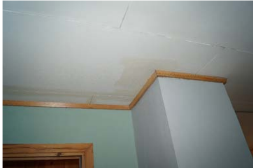
Eldre fukt skjolde i himling på stue
