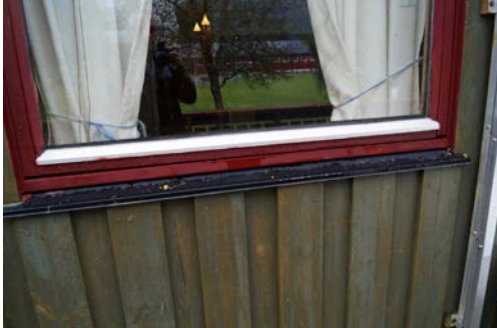
Et stuevindu er slitt og må skiftes
