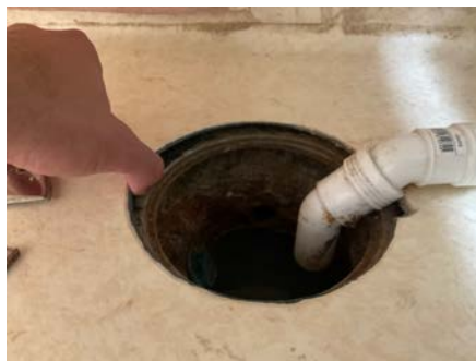
Original støpejern sluk i fra byggeår, vinylbelegg er skåret rundt sluken. Utett løsning.
