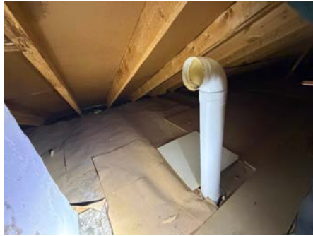
Avtrekk fra kjøkkenventilator ut i kaldloft. Uheldig løsning.
