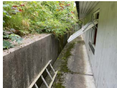
Jevnlig vedlikehold av terreng bak betongmur er viktig, sameiesak.
