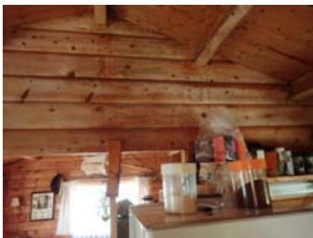
Fuktskjolder i tømmervegg på kjøkken
