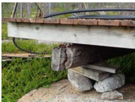
Råteskadet drager under terrassen
