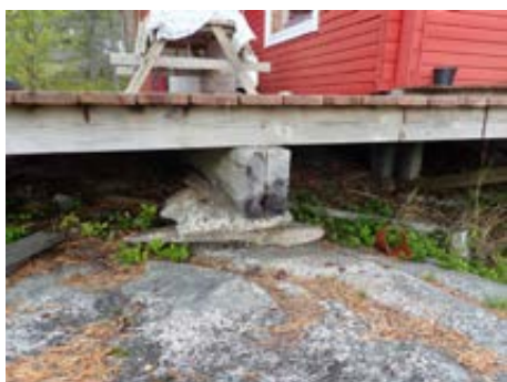
Råteskadet drager under terrassen
