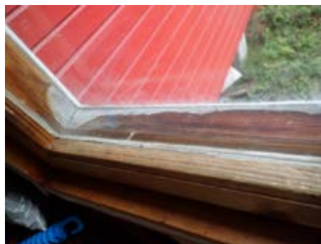
Fukt/råteskader i vindu
