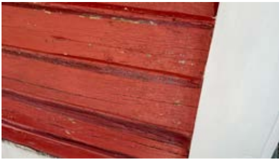
Eldre tømmervegger og utvendig kledning har behov for vedlikehold.
