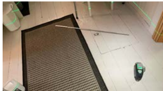
Helningsavvik på ca. 24 mm innen en avstand på 2 meter i kjøkkenområdet.
