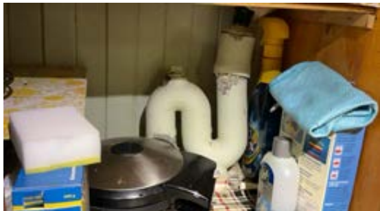
Eldre avløpsrør i kjøkkeninnredning.
