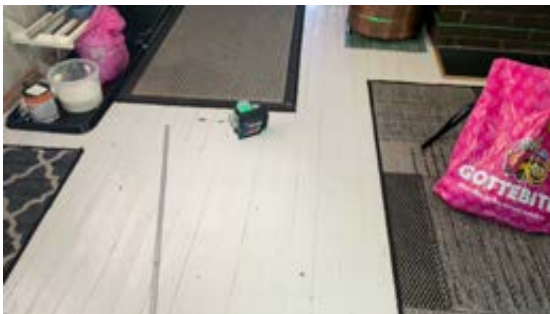
Totalt helningsavvik på ca. 17 mm i stue/kjøkken.
