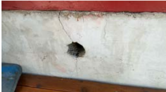
Enkelte sprekker i grunnmur.
