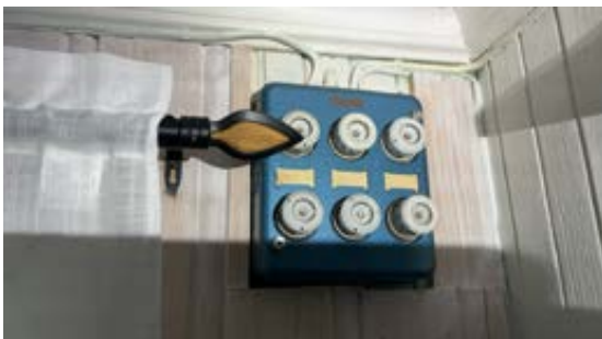
Sikringer i stue/kjøkken.
