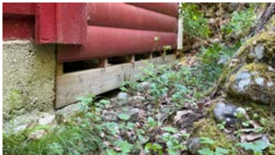
Tilbygd bod: Forenklet fundamentering og sannsynligvis ikke tilstrekkelig bæreevne.
