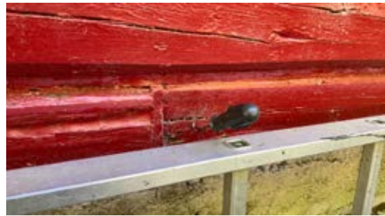
Ved stikkprøvekontroll ble det registrert råteskade bunnstokk på baksiden av hytta. Forholdet gis tilstandsgrad 3.
