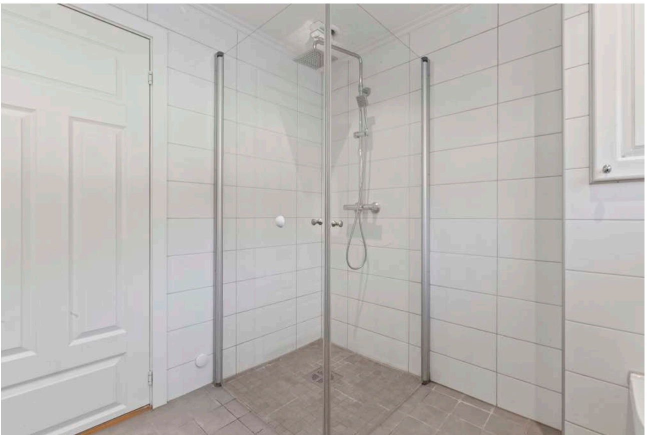
Elektrisk styrt vifte over dusjen. Overstrømming under døren for tilluft.
