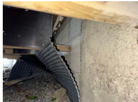
Knotteplasten henger ut fra veggen.
