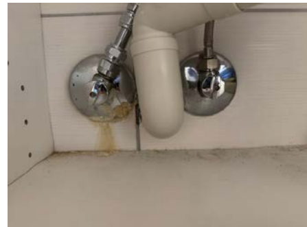
Mulig gammel lekkasje i servantskap. Det er ikke fukt på beferingen.
