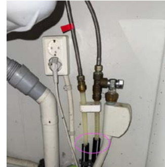
Manglende tettemuffer i benkeskapet på kjøkkenet.
