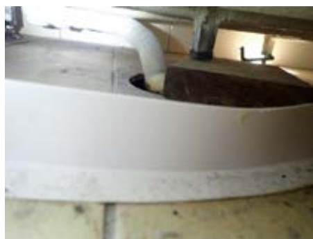
For å begrense vann utover gulvet er det etablert en list som er limt til flisene ved sluk under dusjkabinettet
