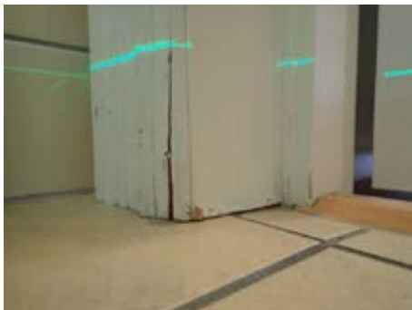
Fuktskade i foring + listverk
