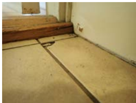
Fukt/vannskader i dør-foring + skade i flis.
