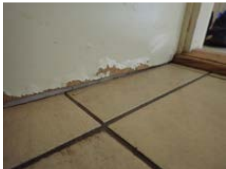
Fukt/vannskader i dør-foring
