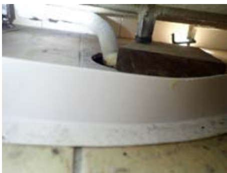
Sluk under dusjkabinett
