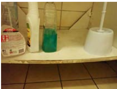
Vannskadet bunnplate i servantskap
