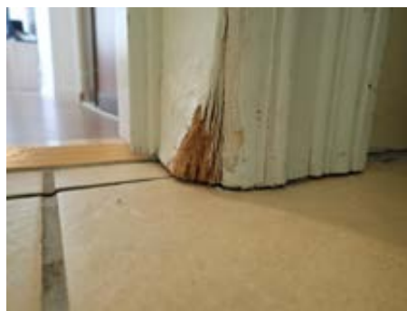
Fuktskader i foring + listverk
