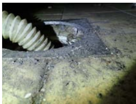
Sluk under dusjkabinett
