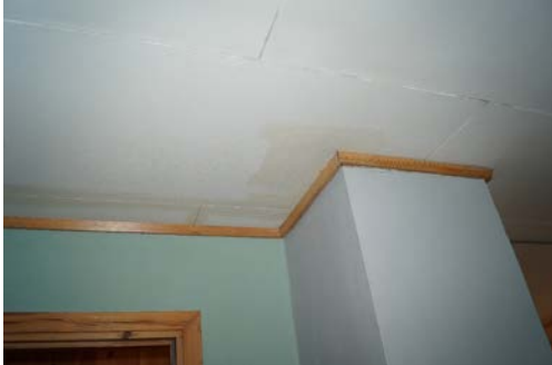
Eldre fuktskjolde i himling på stue
