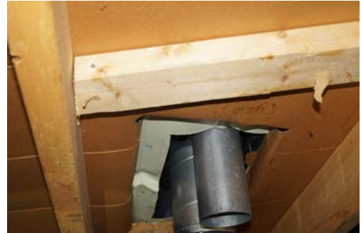
Utett undertak i overgang mot gjennomføring.
