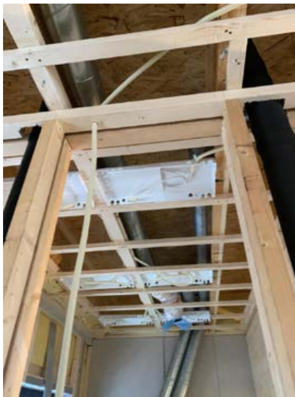
Skjema: "Innfelt belysning - Elektro" Beskrivelse: Bad 2.etg, Filnavn: img_0001.jpg
