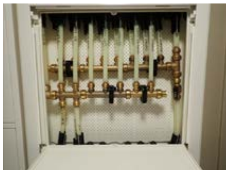
Rør i rør skap for hovedhuset
