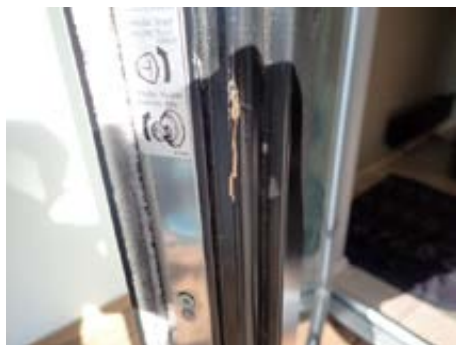
Balkong i 1.etg. med skade i dørbblad
