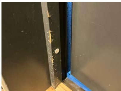
Skade på karm til inngangsdør.
