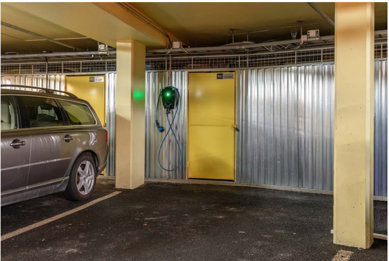
Garasjeplass med elbil lader
