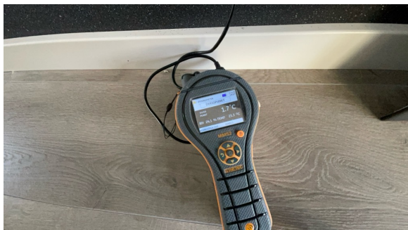
Fuktmåling i vegg mot våtsone
