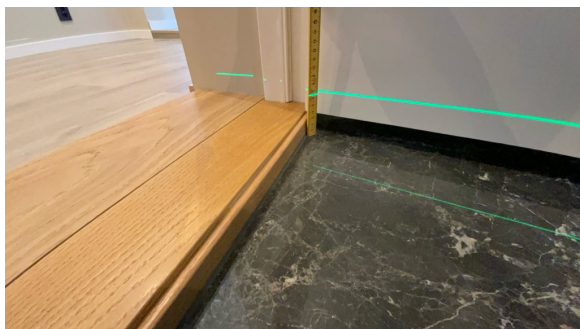
Høydeforskjell (flis ved terskel)
