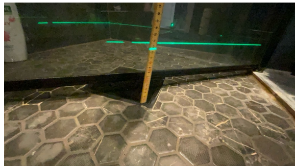
Høydeforskjell (ved sluk)
