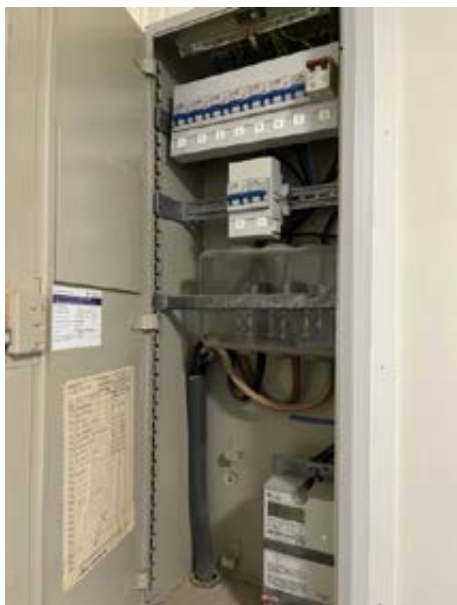
Automatsikringer i EL-skap
