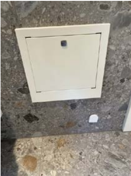
Vannfordelingskap med drenering
