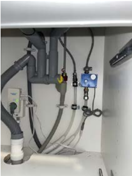
Aquasafe montert på kjøkken
