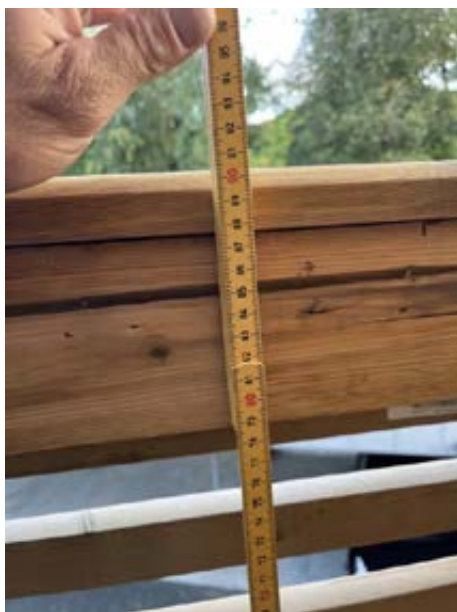
Rekkverkshøyde på under dagens krav.
