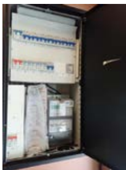
Elskap med 13 kurser over automatsikringer.
