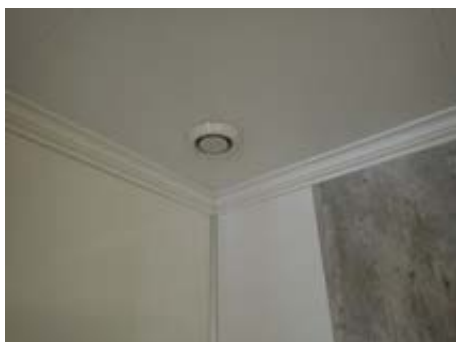
Ventil i tak - ikke etablert tilluft
