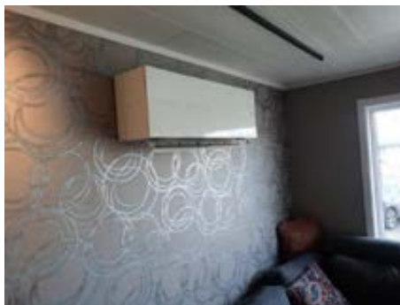
Varmepumpe luft til luft
