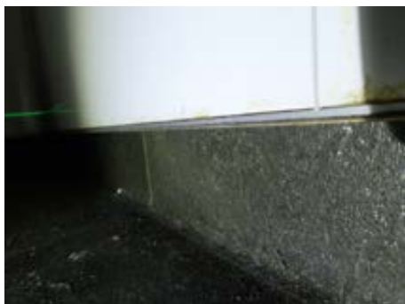
Mangler fuge mellom aluminiumslist og plate
