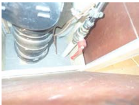
Stoppekran og stakeluke innebygget i kasse.
