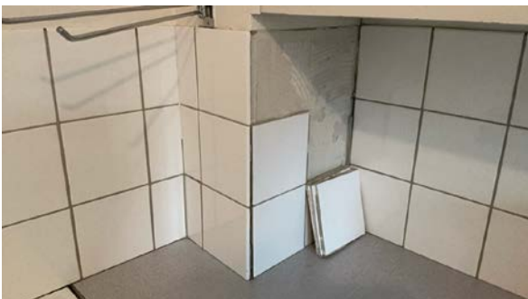
Løse fliser på kjøkkenet.
