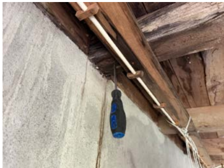
Råte i en takspærre, lite omfang. Normalt vedlikehold må påregnes.
