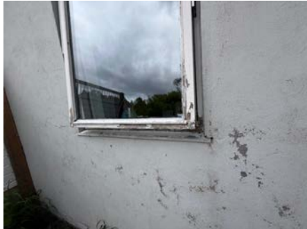
Eksempelbilde av værslitt vindu.
