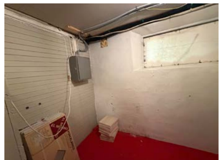
Noe fuktutslag i nedkant av grunnmur i dette rommet også.
