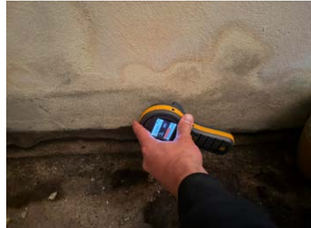
Utslag på fukt i kjellerboden.
