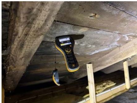
Lofte over vestfløyen. Utslag på fukt i undertaket, 17,5 vektprosent. Fuktmålinger under 17 % er tørt/normale forhold, over 17 % er det økt risiko, over 20% er det fare for mugg og sopp dannelser.
