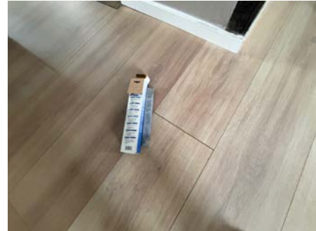
Glippe i endeskjøt på laminatgulv i stue/kjøkken i hovedetasje. Selger skal forsøke å reparere dette før visning/salg.
