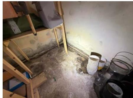
Dette området er det målt fukt.
