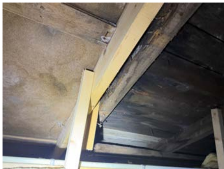
Råteskader i takspærre, takspærre er forsterket.
