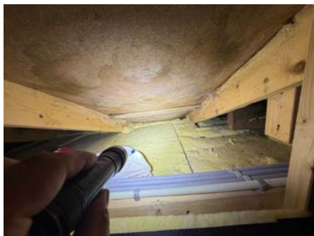
Ikke etablert luftesplate fra raft.
