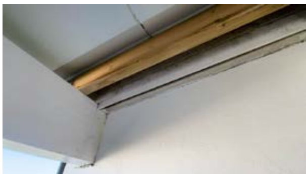
Ikke tilstrekkelig overflatebehandlet kledning.
