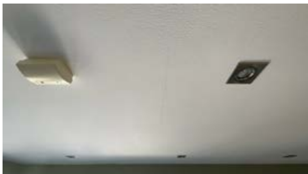
Enkelte riss i plateskjøter
