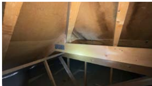
Eksempel på observerte fuktskjolder.
