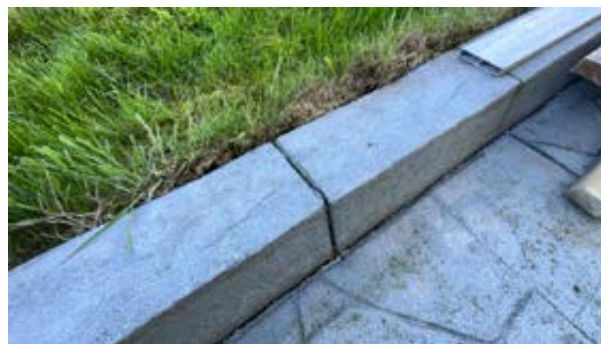
Eksempel på mindre riss. Vanskelig å se på bilde.
