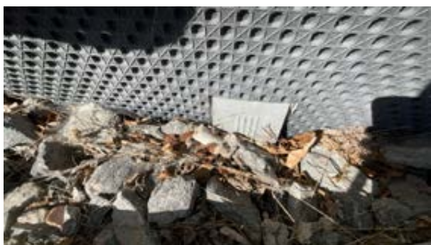
Ventil ligger ned mot terreng
