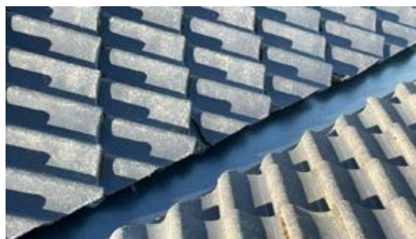
Knekt takstein er observert.
