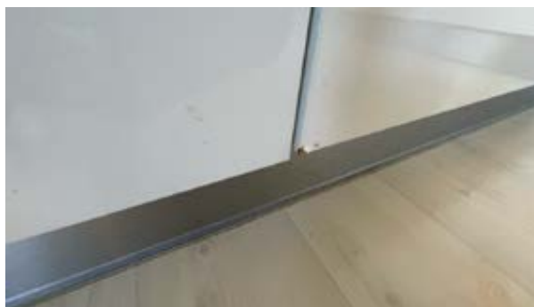
Eksempel på hakk og skader
