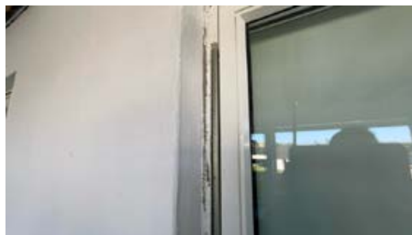
Synlig betongpuss på vindu
