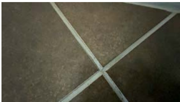
Sprekker i fuger
