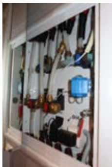
Fordelerskap med rør i rør opplegg. Fordelerskap med rør i rør opplegg.
