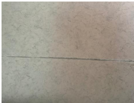
Utett skjøl i gulvet.
