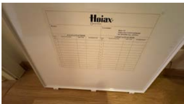
Kursoversikt på innsiden av skapdør er ikke fylt ut.
