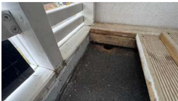
Oppbygging av tetting/takbelegg mot rekkverk er ikke korrekt utført.
