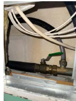
Stoppekran over himling på badet.
