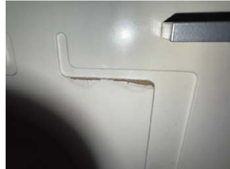
Delaminering på skapfront.
