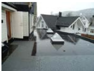
Takterrasse 3.etg. Plastheller og papptekking. Rekkverk mangler.
