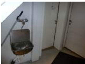
Skyllekar i inngang/ trappeoppgang vest 1.etg., ved toalett.
