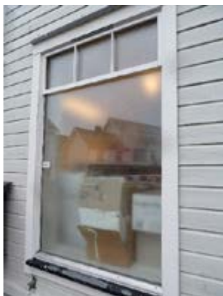
Vindu 1.etg. Risset rute
