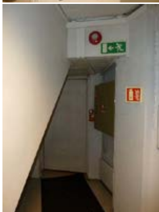
Marking av rømningsveier etg., brannslange, varslingsklokke
