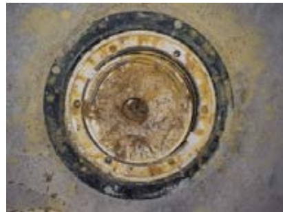
Plastsluk uten synlig tettesjikt.
