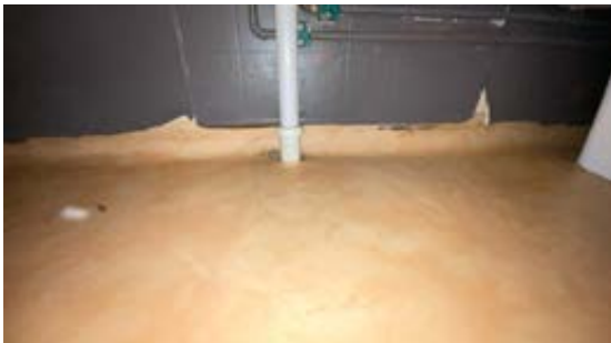
Ikke faglit løsning ved rørgjennomføring av avløpsrør under innredning.
