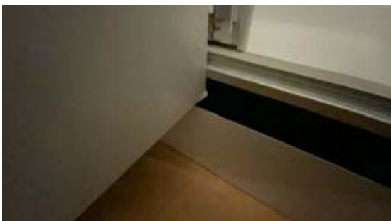
Mindre skade på skapdør.
