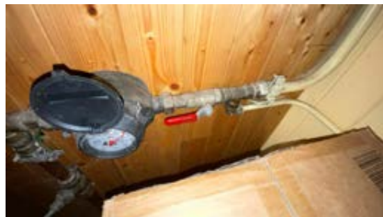
Felles vannmåler i kjeller.
