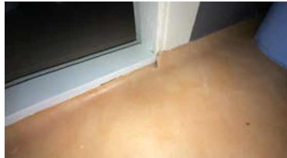
Sprekk i belegg/tettesjikt ved dør.
