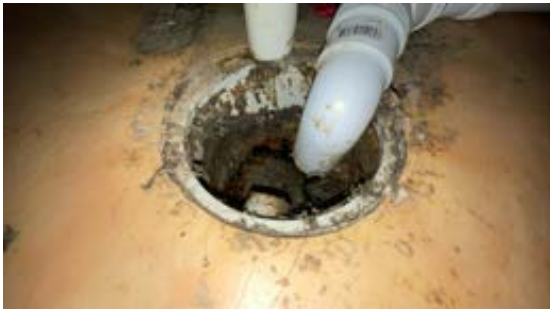
Sluk under dusjkabinett.
