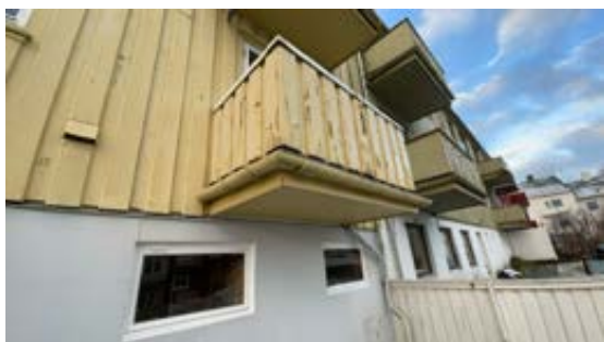
Råteskader i kledning på veranda og vegg mot øst.
