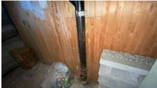
Stigerør av duktilt støpejern med stakemulighet i kjellerbod.
