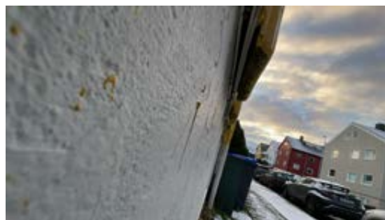
Ikke tilstrekkelig lufting bak kledning og manglende musband.
