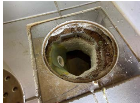
Sluk under baderomsinnredning.
