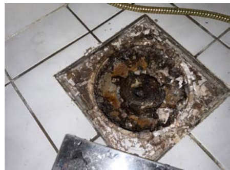
En form for en hjelpesluk i dusjsone. Dette er mest sannsynlig en hjemmelaget løsning.
