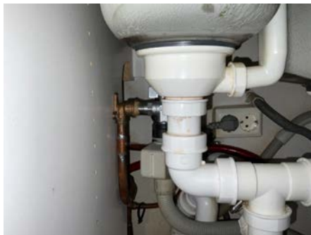
Lekasje i fra rørsjøt.
