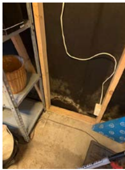
Synlige tegn til fuktighet i bakvegg.
