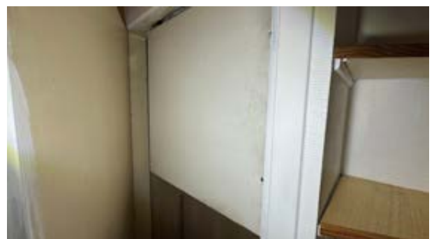
Ventilasjonsagregat uten drift.
