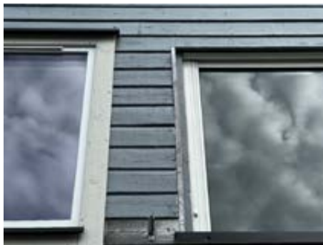
Fukt og råteskadet bordkledning.
