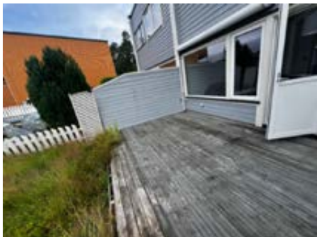
Slitt og dårlig vedlikeholdt terrassedekke.
