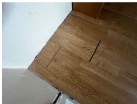
Skjøter har åpent seg.
