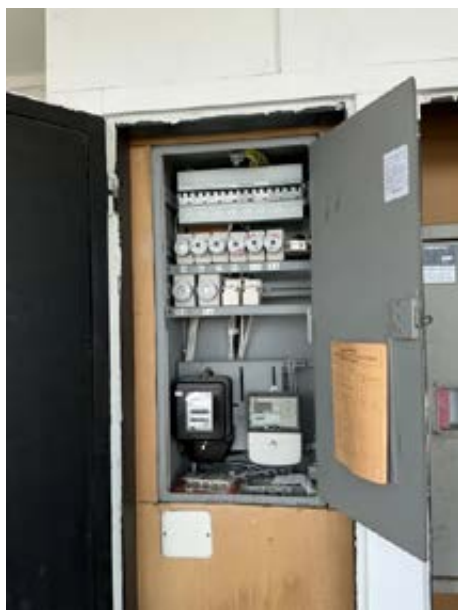
Sikringsskap står i svalgang.
