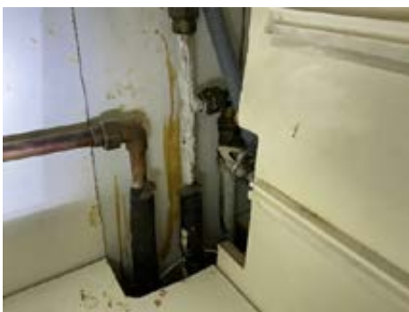
Hovedstoppekran under vask på kjøkken.
